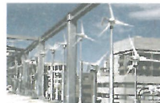
永代橋エコピアザビル屋上小型風力発電機ウィンドファーム
