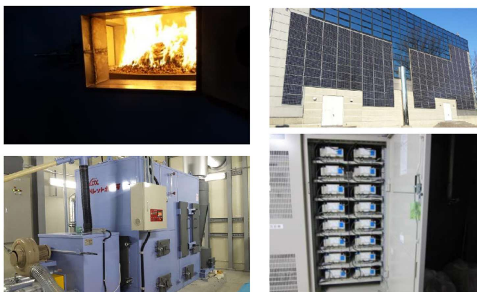
写真3 災害対応型再生可能エネルギー設備導入事業
