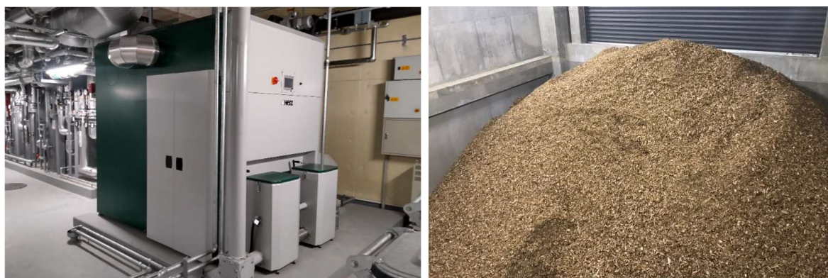
写真6 とうべつ学園 (左: 木質チップボイラ、右: 木質チップ)
