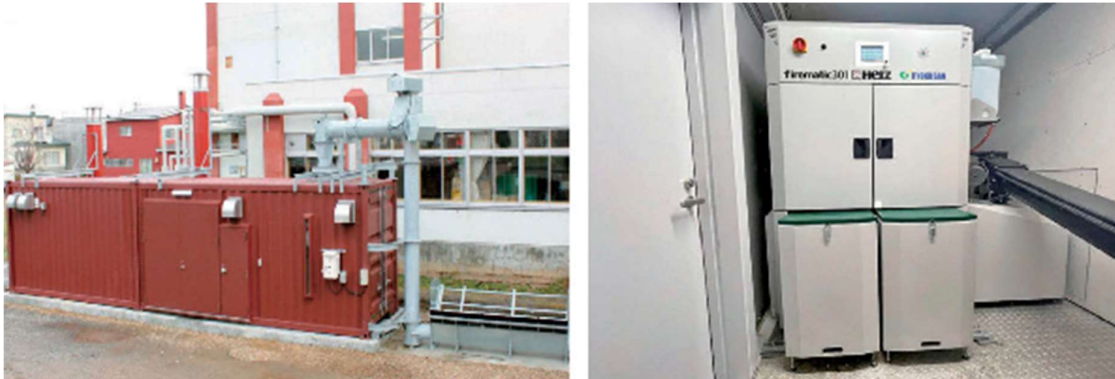
写真 5.5 西当別小中学校木質チップボイラ導入事業 （左：木質チップボイラ施設外観、右：木質チップボイラ本体） 出典：広報とうべつ 2021年7月号
