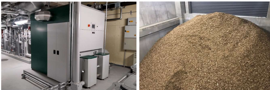
写真 5.6 とうべつ学園（左：木質チップボイラ、右：木質チップ）
