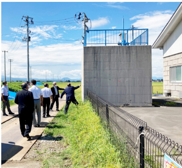
大雨により浸水した揚排水機場
