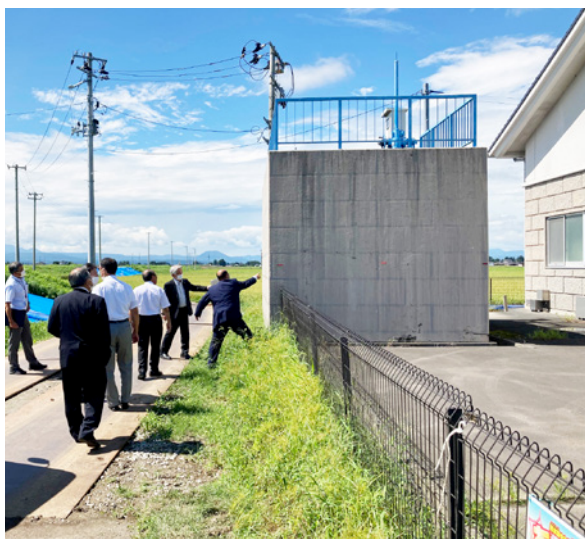
大雨により浸水した揚排水機場
