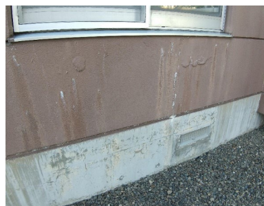
新春日団地95-1 (4号棟) 摩耗、ふくれ、剥がれ (劣化デグレードが20%未満)
