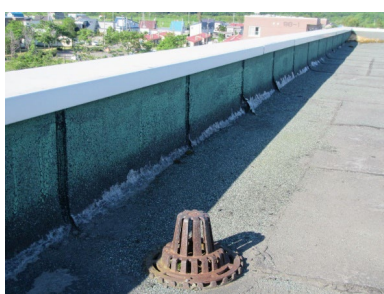
新春日団地95-2 (5号棟) 防水層の破断、ふくれ (頻度: 多数) 接合部の破断、口開き (頻度: 多数)
