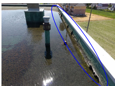
新春日団地94-1 (2号棟) 防水層の破断、穴あき、ふくれ (頻度: 多数) 保護塗装の摩耗、剥がれ (頻度: 多数)
