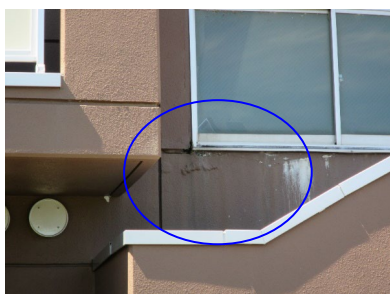
新春日団地94-1 (2号棟) 摩耗、ふくれ、剥がれ (劣化デグレードが20%未満)
