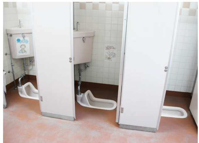
和式トイレ (西当別小学校)
