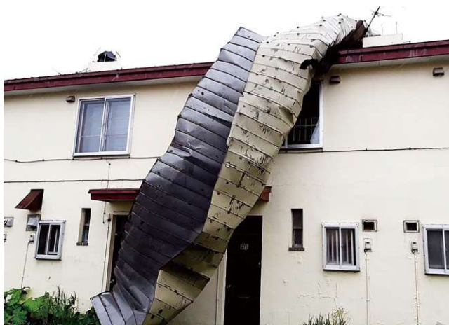
強風により剥がれた屋根(東町団地)
