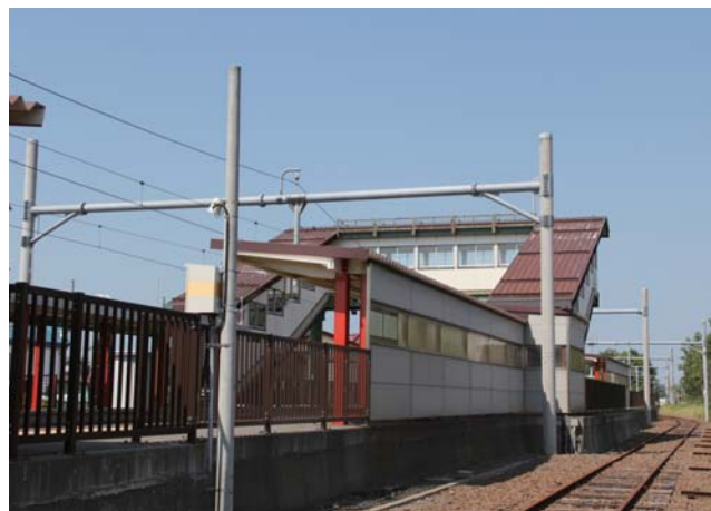
ハトのふんで問題に取り上げられている太美駅跨線橋
