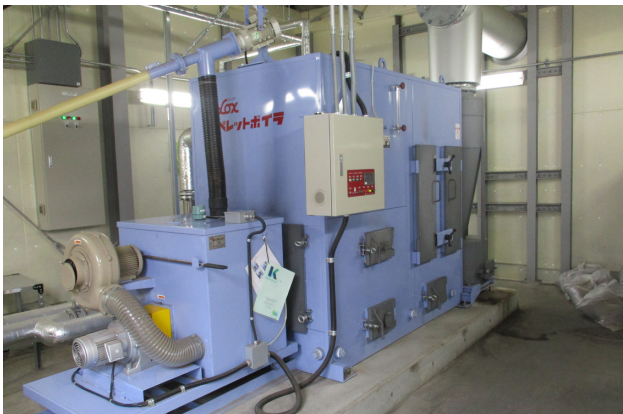
総合体育館の木質ペレットボイラ
