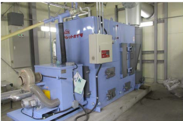
総合体育館の木質ペレットボイラ
