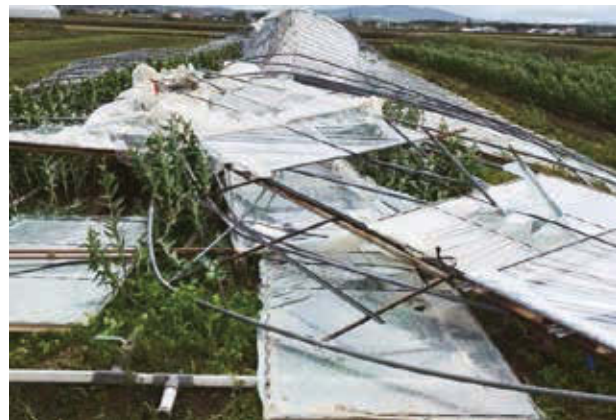
台風21号により倒壊したビニールハウス
