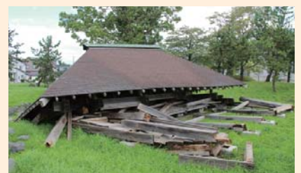
和風庭園あずまの柱が崩れ倒壊 (白樺公園内)
