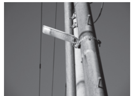
LED化された街路灯
