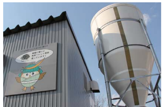
総合体育館敷地内に設置した木質ボイラー
