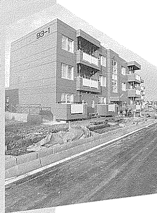
▶1棟19戸が完成した、春日団地の町営住宅。平成9年までに、合計7棟116戸が完成の予定。(9月)
