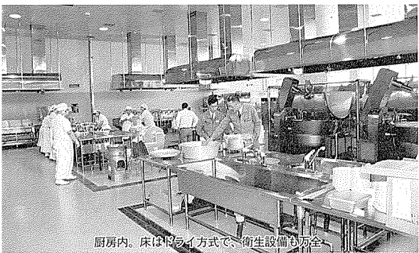
厨房内。床はドライ方式で、衛生設備も万全
