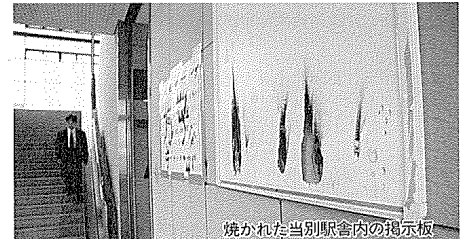
焼かれた当別駅舎内の掲示板
