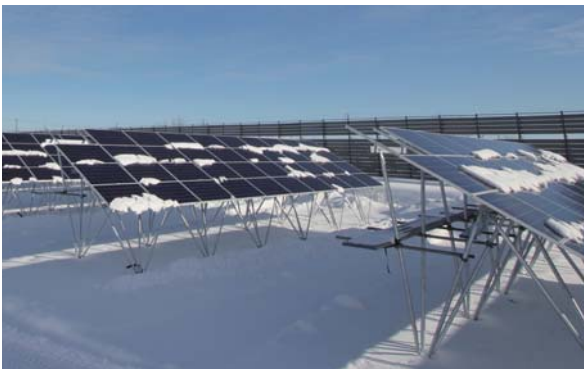
写真：蕨岱に設置されたメガソーラー
