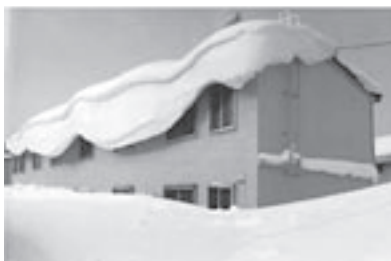
雪庇でおおいかぶさる雪 (東町団地 2F 建住宅)
